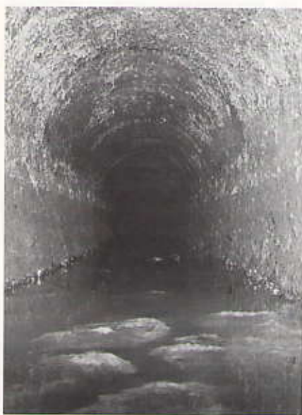
Het Van Stolkpark gaat in 1996 toch niet op de schop. Bij nadere beschouwing bleek de riolering na bijna 100 jaar nog vrijwel puntgaaf, zoals u op de foto kunt zien. (Foto Hoofdafdeling DSB/Riolering en Waterbeheersing).
